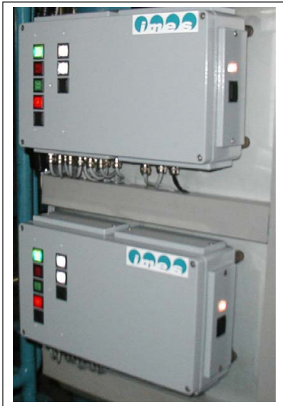
Abb.8: Zwei ZAD-Baugruppen an einem 20 Zylinder Gasmotor
